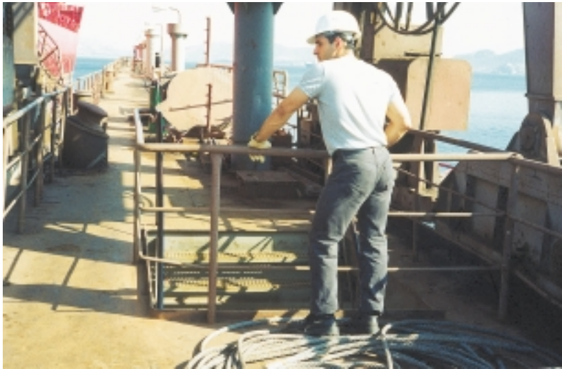
Εικόνα 4.4: Όπου υπάρχουν βαθιά ανοίγματα, πρέπει να περιφράζονται με προστατευτικά κιγκλιδώματα.
