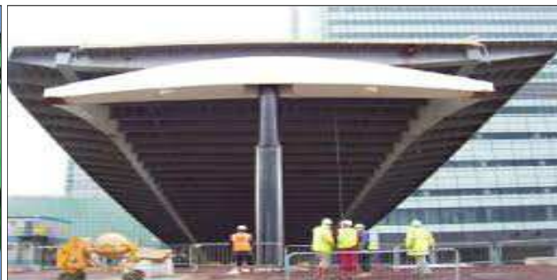
Υδραυλικός κύλινδρος υδραυλικού συστήματος (σε λειτουργία) ανύψωσης γέφυρας
