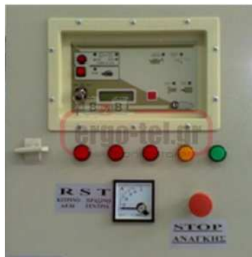
Πίνακας ελέγχου ηλεκτρογεννήτριας ανάγκης
