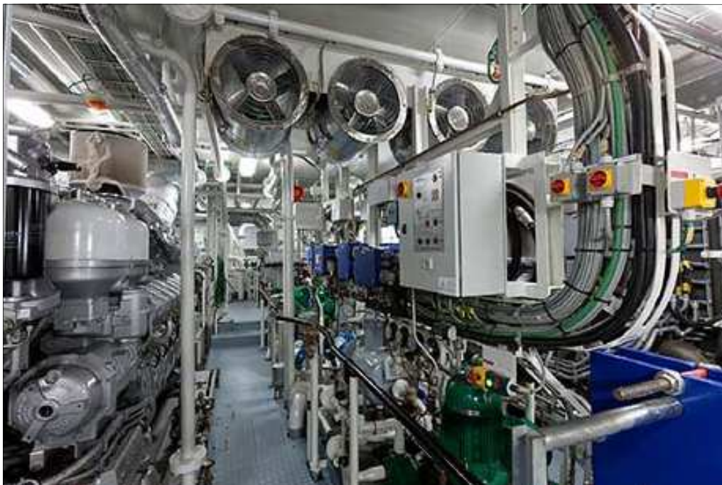
Συγκρότημα ανεμιστήρων σε μηχανοστάσιο σκάφους
