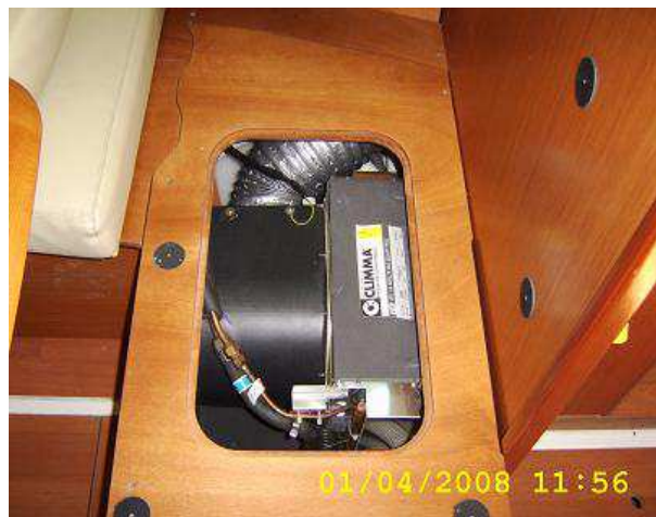
Ψυκτικό στοιχείο ή fan coil
