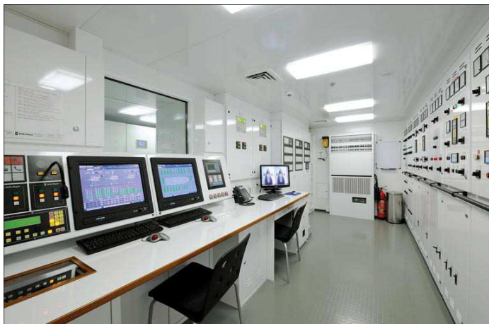
Αίθουσα (χώρος) ελέγχου μηχανών σκάφους (engine control room)
