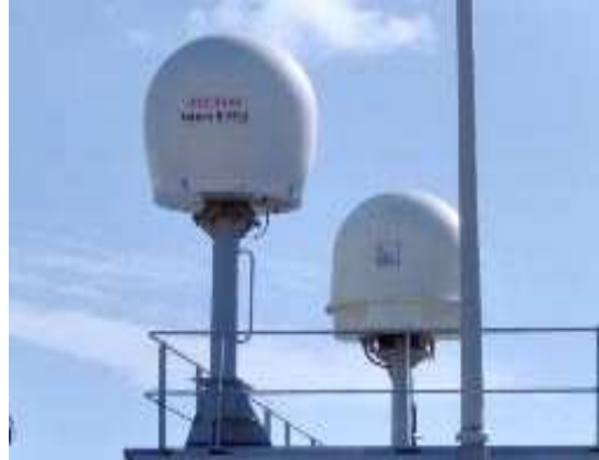
Η κεραία του συστήματος Inmarsat είναι τοποθετημένη πάνω σε πλατφόρμα σε σύστημα σταθεροποίησης για να σκοπεύει το δορυφόρο ανεξάρτητα από την κίνηση του πλοίου.
